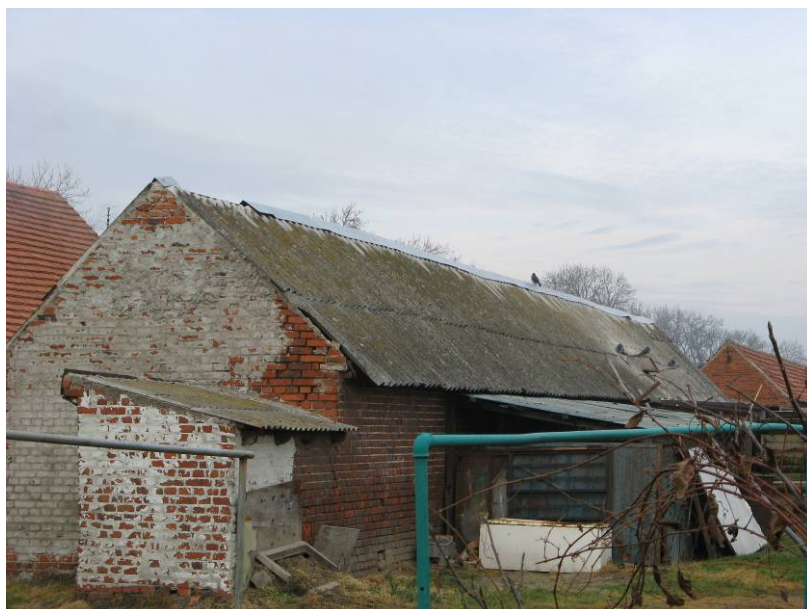
Fot. 13 .Płyty azbestowo-cementowe na budynkach w Kruczynie – II stopień pilności.
