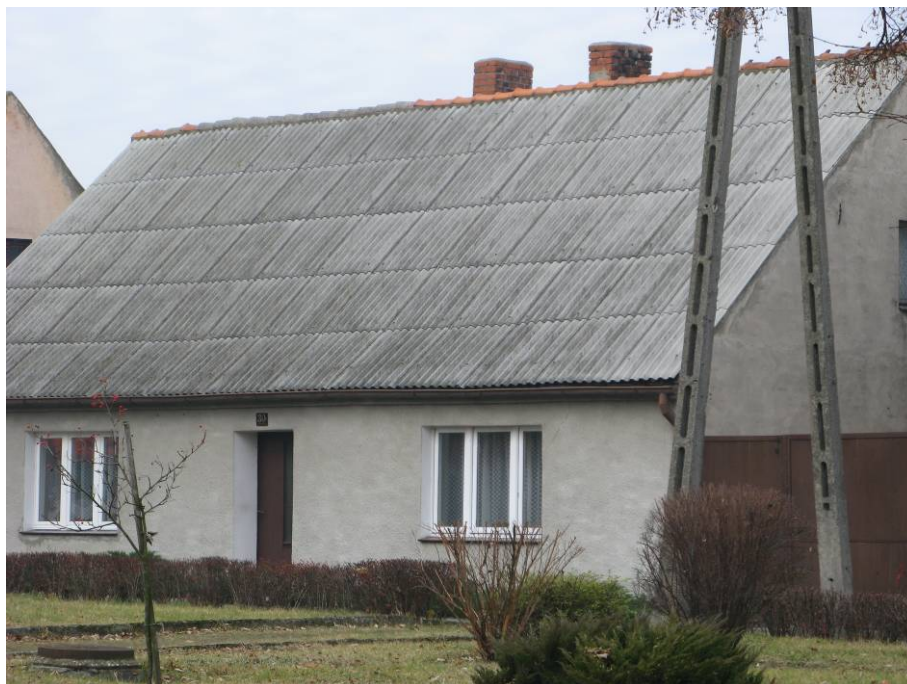
Fot. 3. Płyty azbestowo-cementowe faliste na budynku jednorodzinym w Nowym Mieście.
