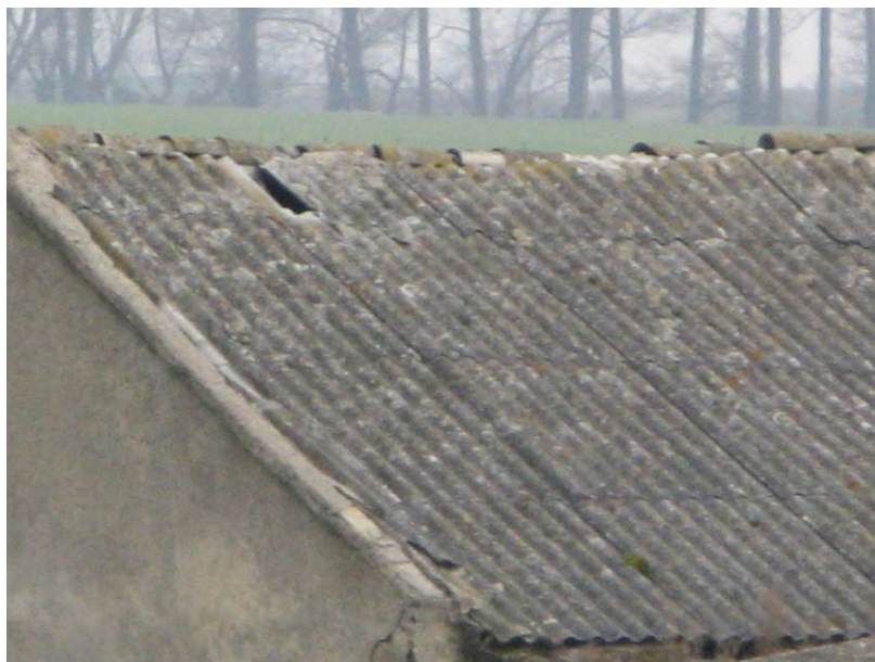
Fot. 12. Uszkodzone płyty azbestowo-cementowe na budynku w Chwałęcinie – I stopień pilności.
