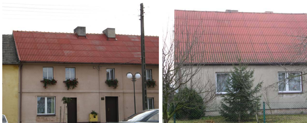
Fot. 7 i 8. Płyty eternitowe pomalowane farbą na budynkach mieszkalnych w Nowym Mieście n/Wartą i Komorzu.
