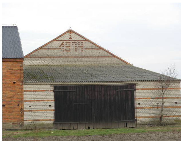
Fot 4. Płyty azbestowo-cementowe faliste na budynku garażowym w Kruczynie.
