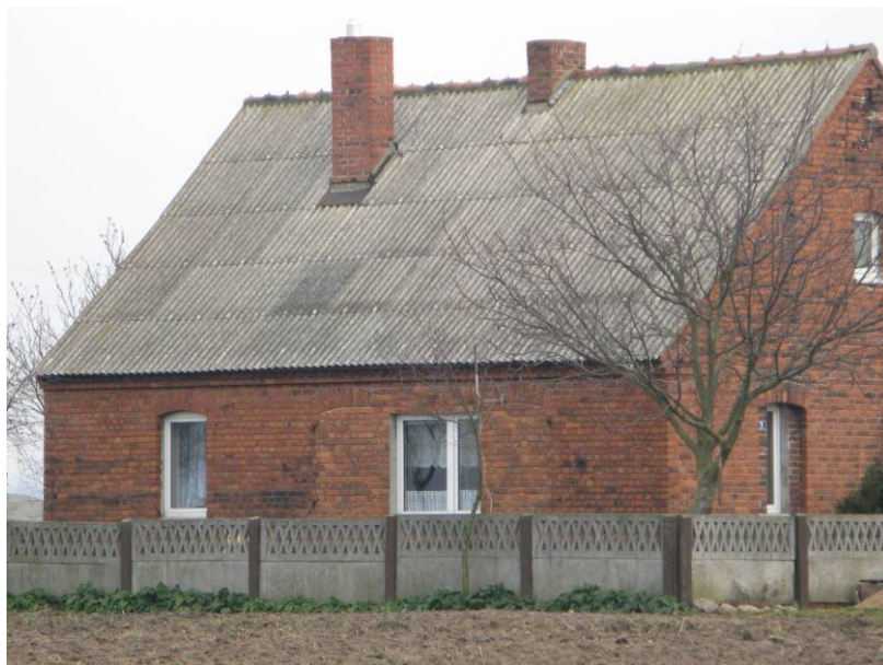
Fot. 14 .Nieszkodzone płyty azbestowo-cementowe na budynku w Kruczynie – III stopień pilności.
